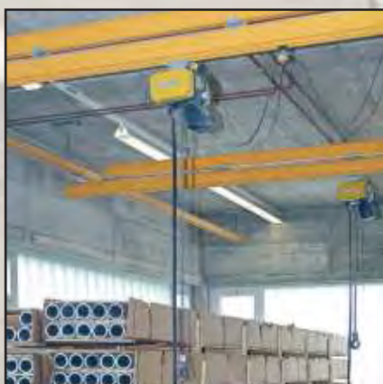
* Grúa suspendida monorraíl.
